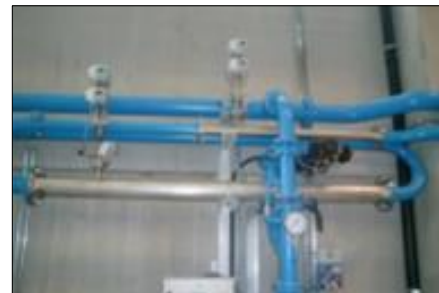
2 tubi di misurazione (acciaio inox) DN80 e DN150 con 2 PoetterSensors® e 2 trasduttori DP per ciascun tubo.
